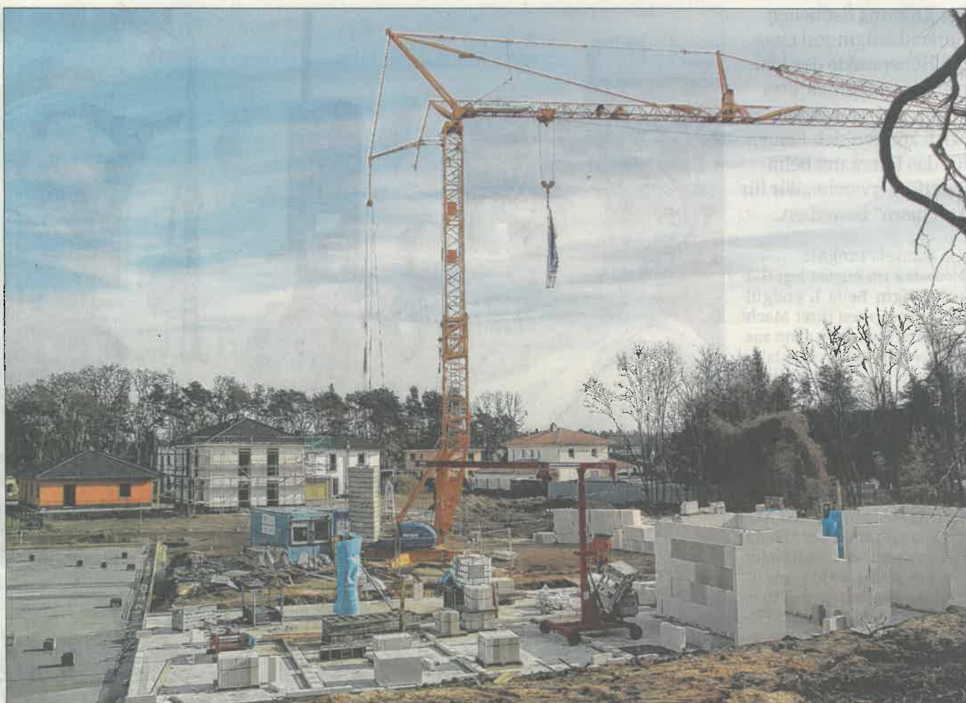
Derzeit ruhen wegen der kalten Witterung die Bauarbeiten am Naturfreundeweg zwar, aber es ist nach wie vor das Ziel der Investoren, dass das neue Seniorenheim im Sommer kommenden Jahres fertig ist. Fotos (4): Thomas Rauwald
